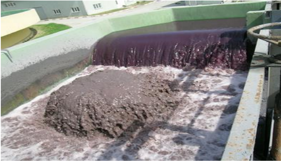
Şekil 1.4. Havalandırma havuzu giriş ünitesi
