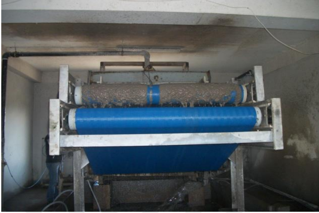
Şekil 1.5. Çamur susuzlaştırma ünitesi belt filtreler
