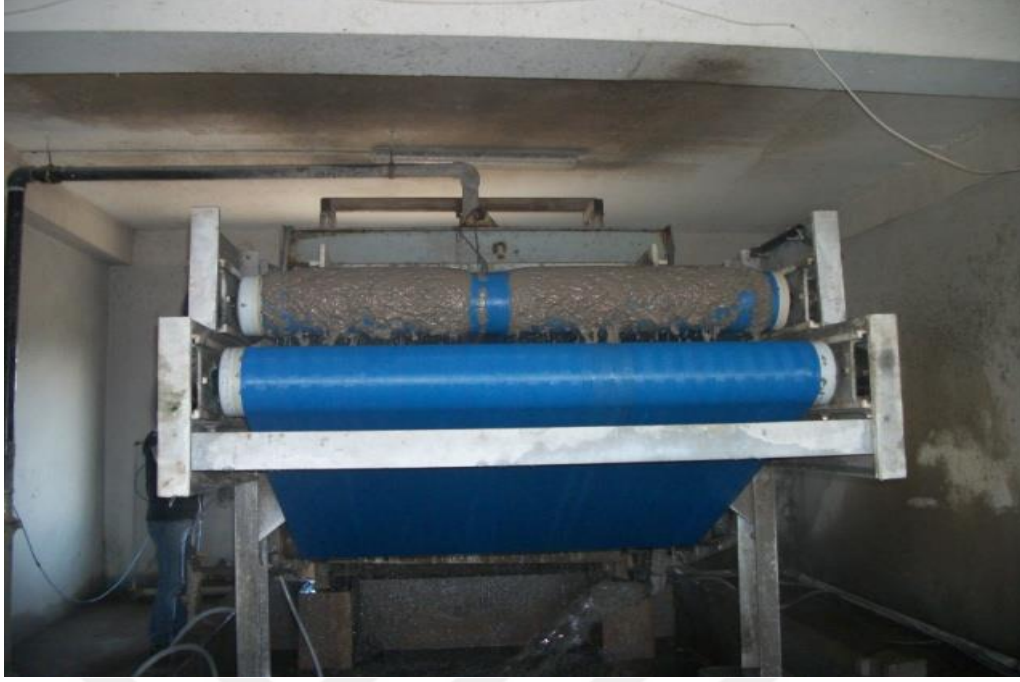
Şekil 1.5. Çamur susuzlaştırma ünitesi belt filtreler
