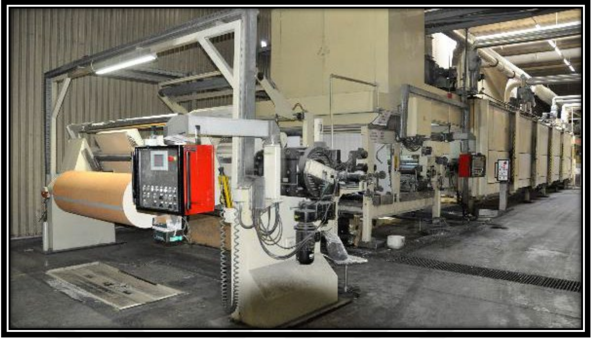
Şekil 1.12: Melamin kâğıt üretim hattı genel görünüşü.
