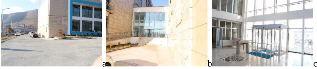
Şekil 89: Engelli girişine yönelik fiziksel erişim için gerekli uygulamalardaki eksik ve hatalı uygulamalar: a) Klavuz iz uygulaması ve yönlendirici işaretlerin olmadığı meydan alanı, b) Korumacı üst örtü, cam yüzeyde uyarıcı işaretleme ve klavuz iz uygulaması bulunmayan giriş mekânı, c) İç mekânda parlak ve kaygan zemin, zemine sabitlenmeyen paspas
