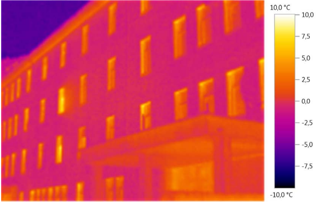
Şekil 2.144. Torul Yatılı Bölge İlköğretim Okulu Termal Kamera Görüntüsü
