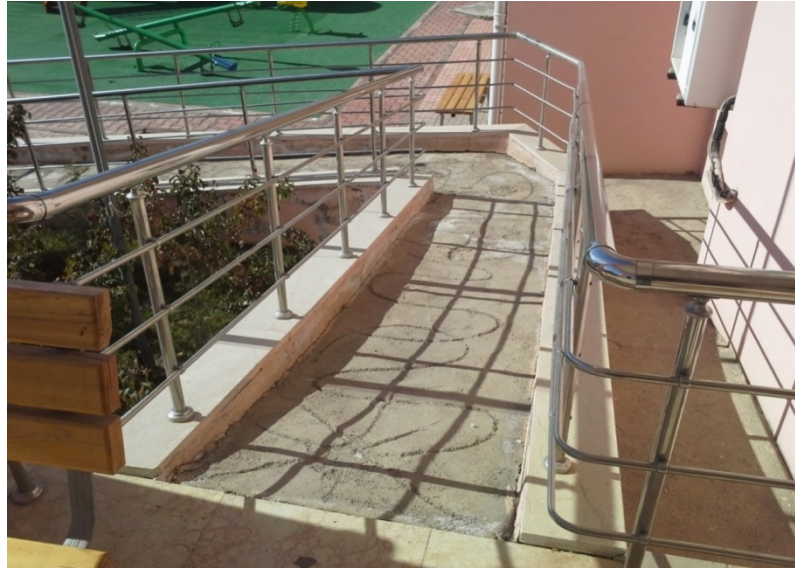
Fotoğraf 5. Rampa zemini uygun değil. (Olumsuz Örnek)
