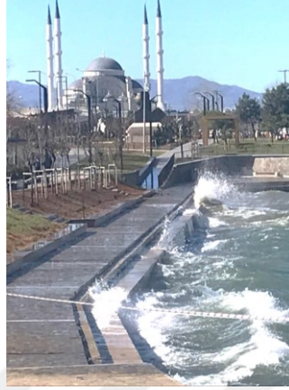
Şekil 38. Parapet bulunmayan kıyı alanı örneği
