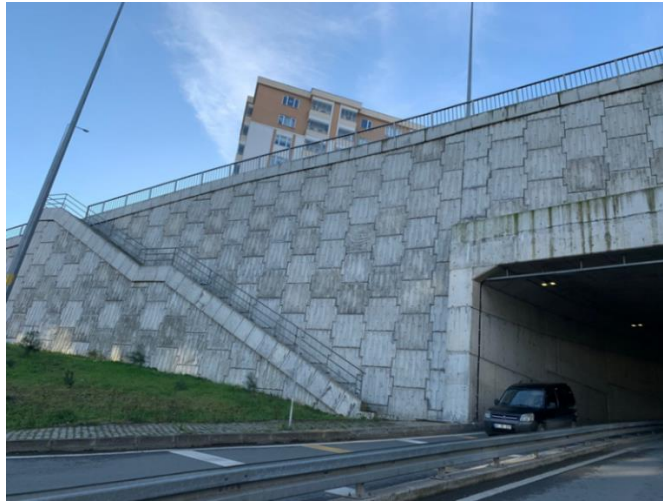
Şekil 80. Siyamoğlu Sokak'tan Kanuni Bulvarı köprüyol altı geçişine girişteki kaldırım bitişi (Kaynak: Gülçin Eren Arşivi, 2023)
