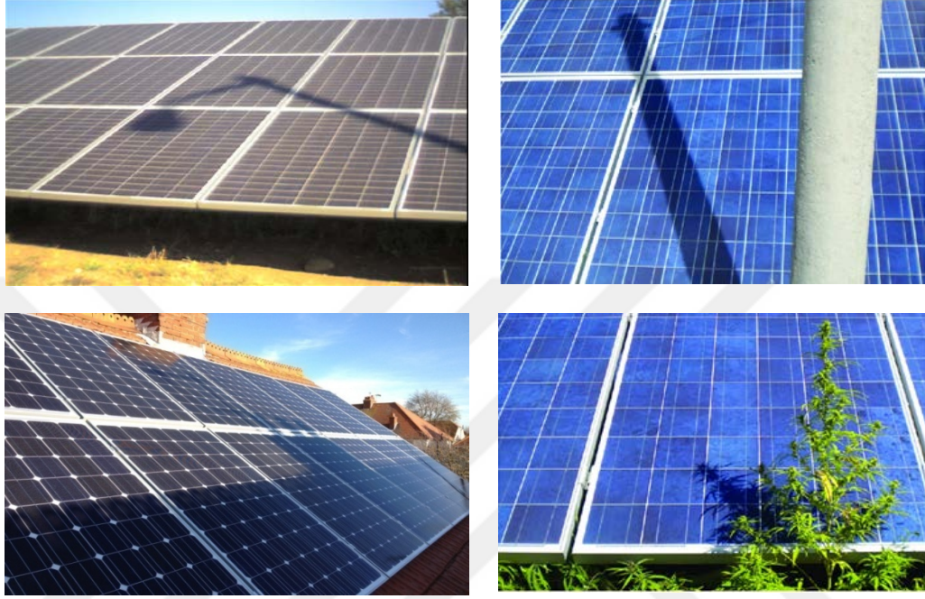
Şekil 4.2. Ağaç, elektrik direği, aydınlatma direği ve bacanın panelleri gölgelemesi 9
