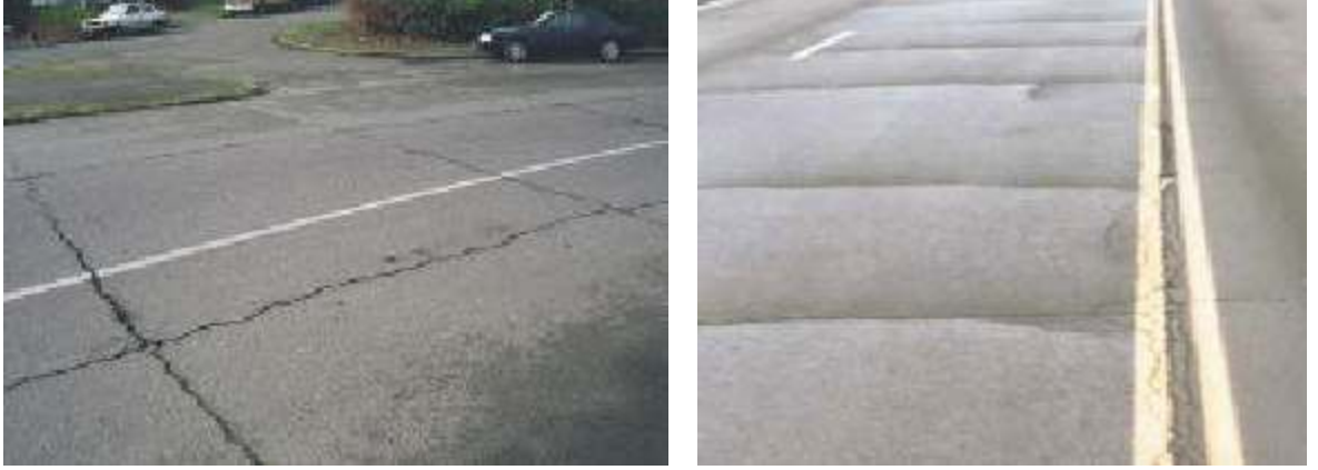
Şekil 4.9 Yansıma çatlakları (URL -1, 2007)
