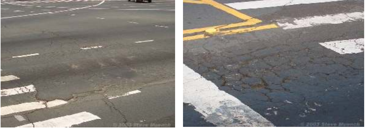
Şekil 4.5 Yorulma çatlakları (URL -1, 2007)
