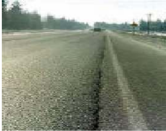
Şekil 4.6 Kenar çatlakları (URL -2, 2007)
