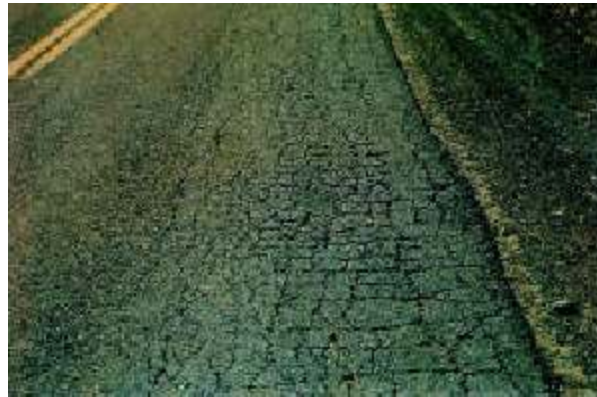
Şekil 4.4 Timsah sırtı çatlakları (URL -2, 2007)
