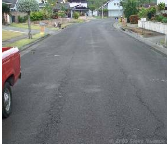
Şekil 4.7 Derz çatlakları (URL -1, 2007)
