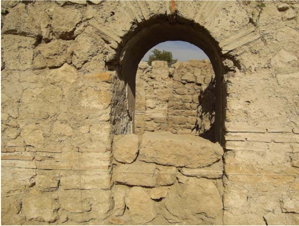
Resim 3.40. Yapının stucco sıva kaplamasında dökülme ve malzeme kaybı (Fotoğraf: Biçer)
