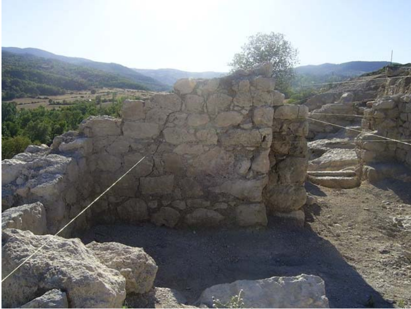
Resim 3.38. Duvarlarda meydana gelen yapısal bozulmalar (Fotoğraf: Biçer)
