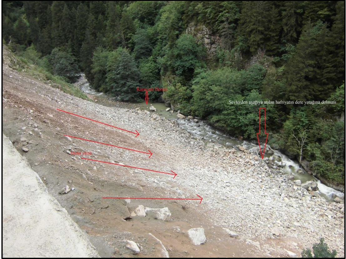
Şekil 7. Alçak Köprü mevkiinde yol açma faaliyetleri sırasında dere yatağına hafriyatın dolması.
