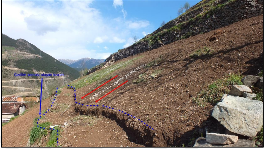
Şekil 82. Karaçam yerleşim biriminde eğim nedeniyle tarım alanında oluşan gerilme.
