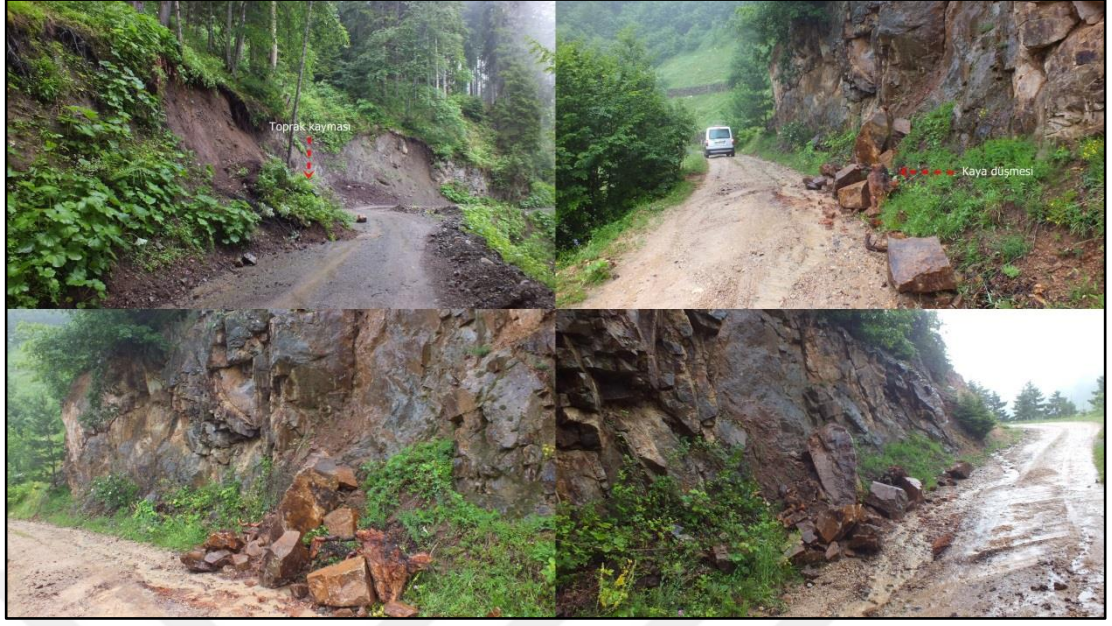
Şekil 53. Araştırma sahasında yol üzerinde görülen kaya düşmesi ve küçük çaplı heyelanlar.
