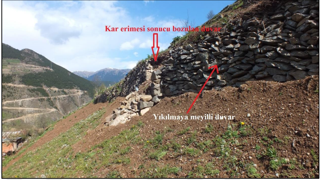
Şekil 81. Karaçam yerleşkesi saadet mahallesinde kar erimesi sonucu bozulan duvardan bir görünüm (kuzeye bakış).
