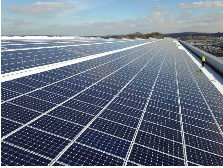
Şekil 22. Çatı üstü fotovoltaik sistem örneği (URL-14, 2024)
