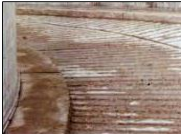
Şekil 2.5. Beton kaplamada oluşan soyulma problemi (Baradan,2010).
