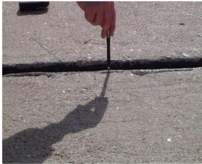
Şekil 1.2. Oturma yapmış beton plak (Anonymous 2021c)
