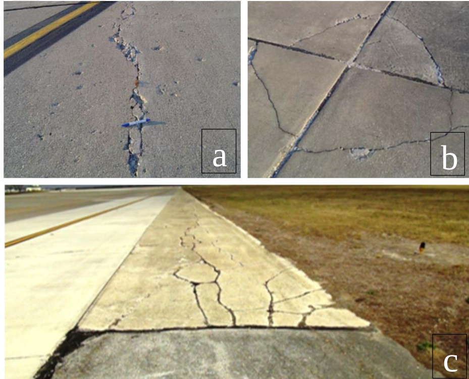
Şekil 1.1. Rijit üstyapıda a) orta panel çatlağı b) köşe çatlağı c) parçalanmış levha çatlağı (Anonymous 2021c).
