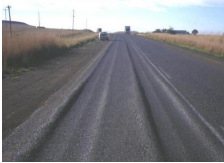
Şekil 1.6. Yolda oluşan tekerlek izi kusuru (Junior 2019)
