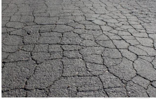
Şekil 1.10. Yolda yorulmadan kaynaklı oluşan timsah sırtı çatlaması (Anonymous 2021e).
