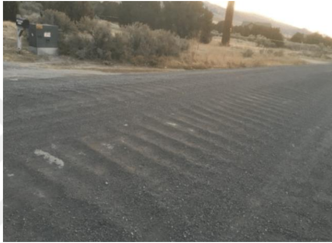
Şekil 1.5. Yolda oluşan ondülasyon kusuru örneği (Anonymous 2021d)
