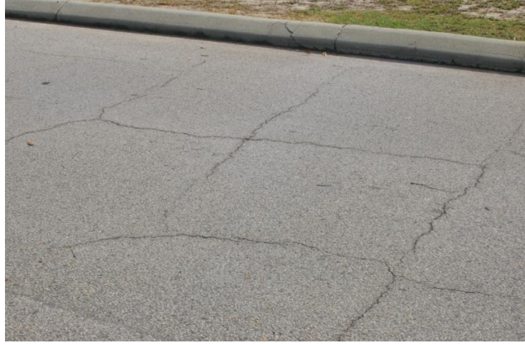
Şekil 1.15. Yolda oluşan blok çatlama kusuru (Anonymous 2019)
