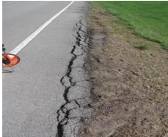
Şekil 1.13. Yolda oluşan kenar çatlama kusuru (Anonymous 2015)
