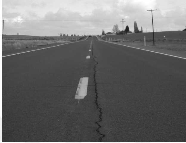
Şekil 1.12. Yolda oluşan boyuna çatlama kusuru (Anonymous 2019)
