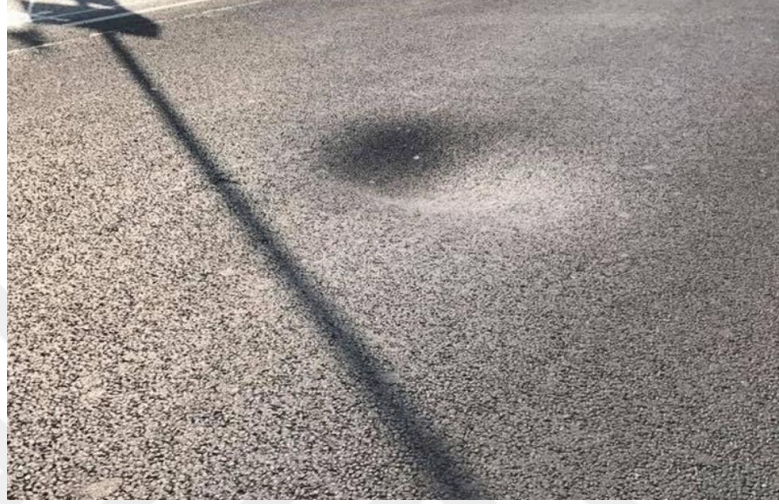
Şekil 1.8. Yolda oluşan yerel çöküntü kusuru örneği (Anonymous 2017)
