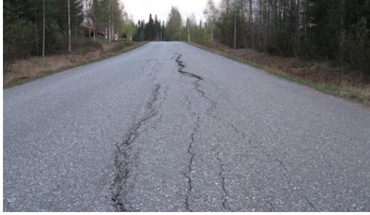
Şekil 1.9. Yol yüzeyinde kabarmadan kaynaklı çatlama (Anonymous 2019)
