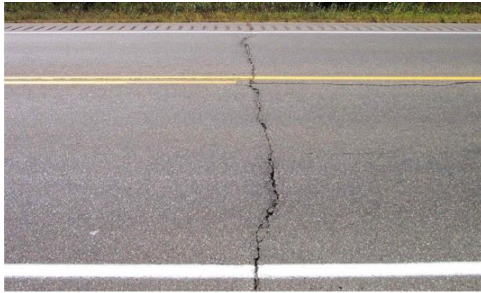
Şekil 1.11. Yolda oluşan enine çatlama kusuru (Anonymous 2011)
