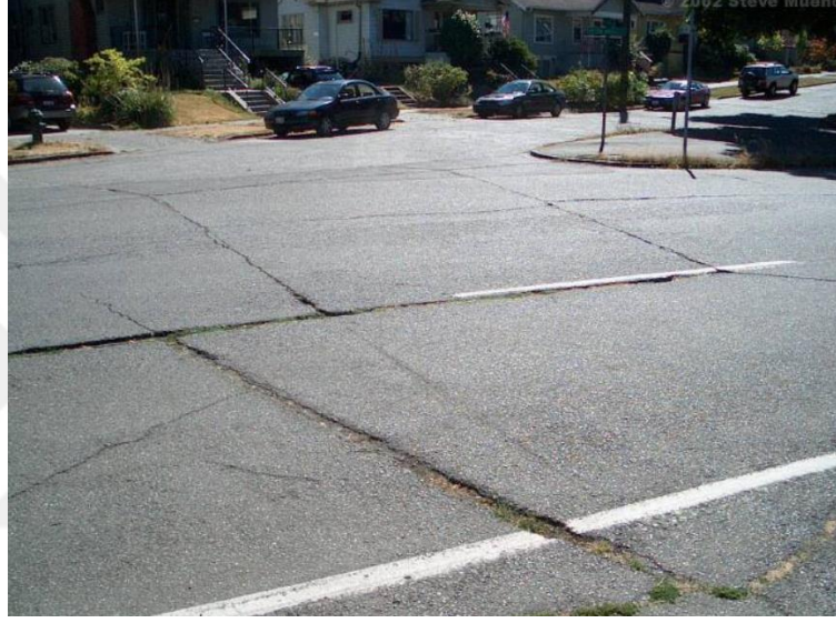
Şekil 1.14. Yolda oluşan yansıma çatlaması kusuru (Anonymous 2021f)
