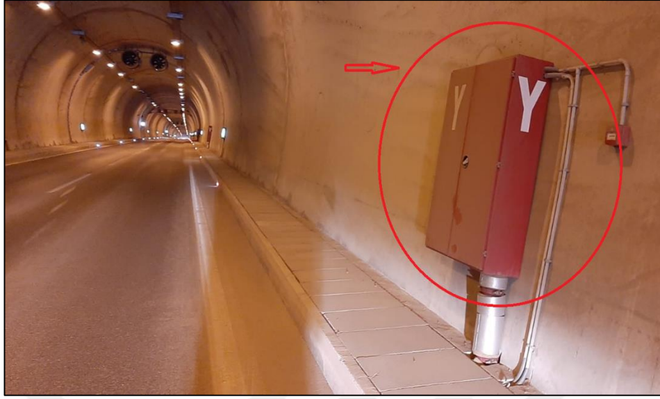
Şekil 1.23. Karayolu tüneline tefriş edilen yangın söndürme dolabı
