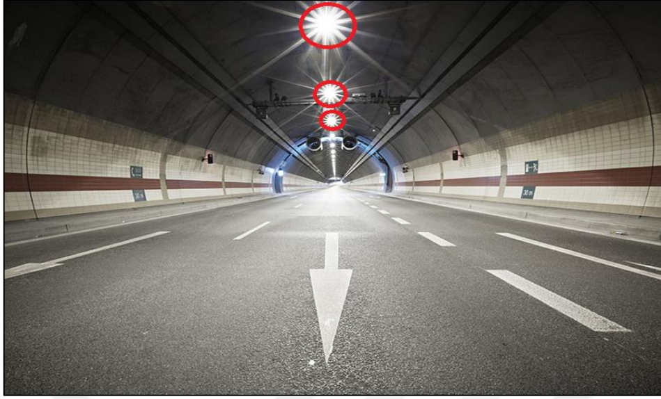
Şekil 1.17. Tünel aydınlatma sistemi (URL-14, 2020).
