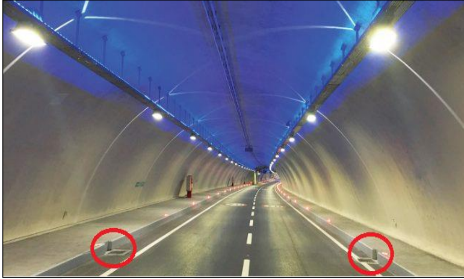
Şekil 1.6. Drenaj sistemi mazgalları (URL-9, 2020).
