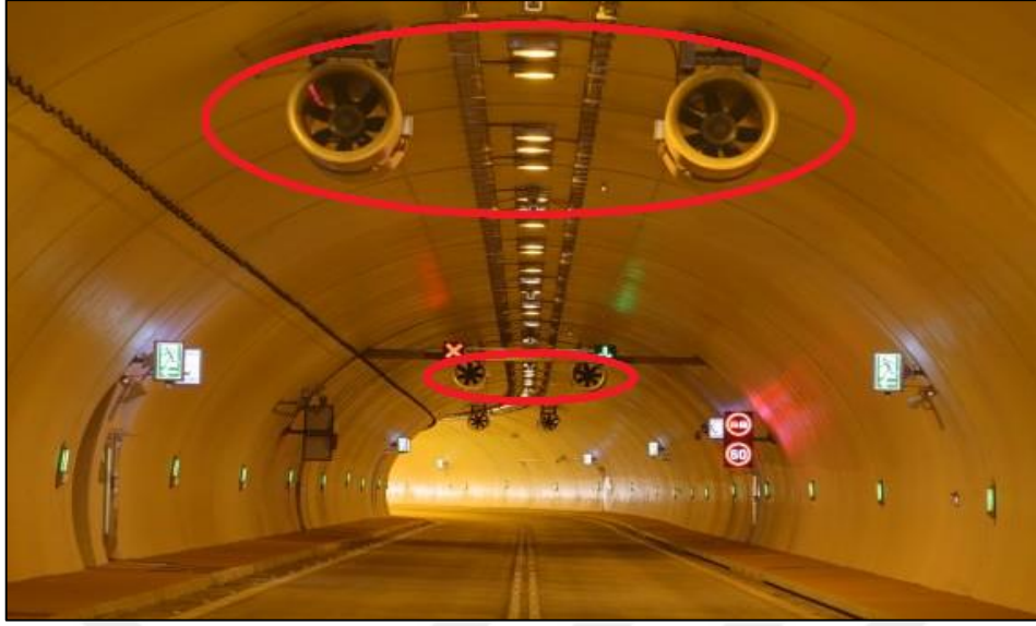
Şekil 1.19. Tünel havalandırma sistemi (URL-11, 2020).
