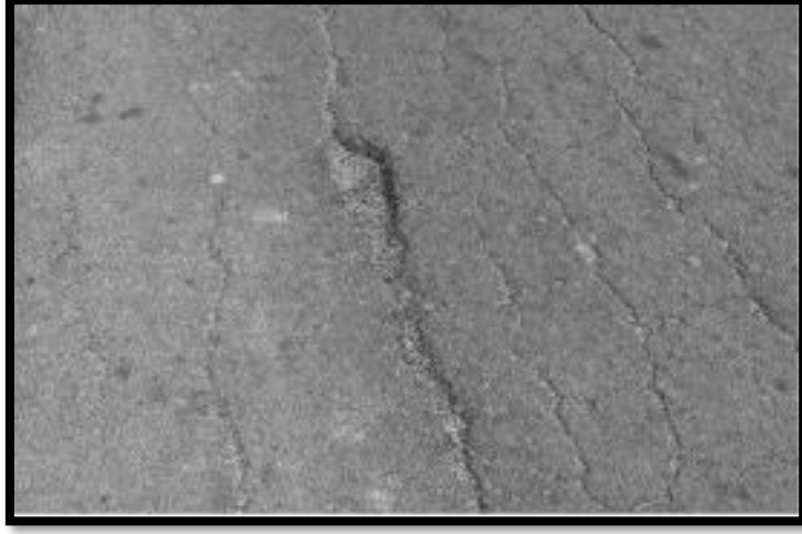
Şekil 3.6. Boyuna çatlaklar (Adlinge ve Gupta, 2013)
