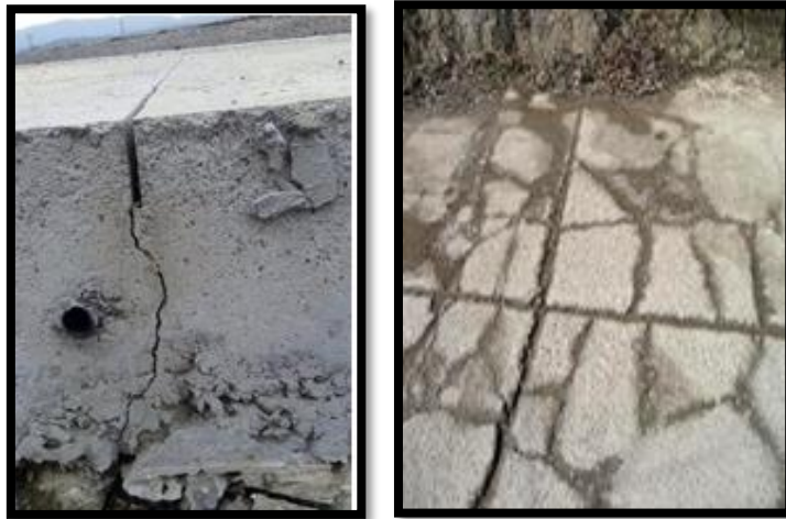
Şekil 3.8. Yarım derz ve yol üzerindeki çatlaklar (Çelik ve diğ., 2020)
