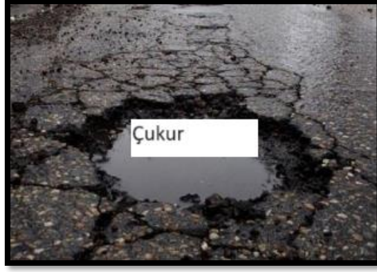
Şekil 3.7. Yetersiz drenaj sebebiyle oluşan çukur (Wang ve diğ., 2021)
