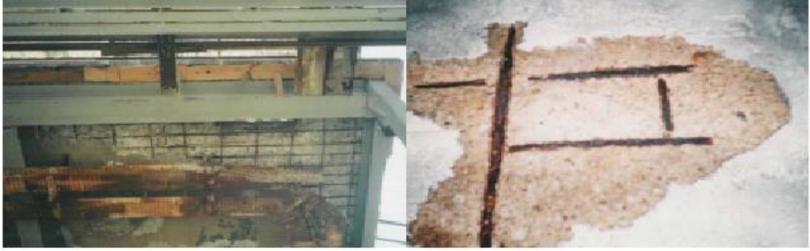
Şekil 1.10. Denize yakın ortamlarda korozyon hasarları [10].
