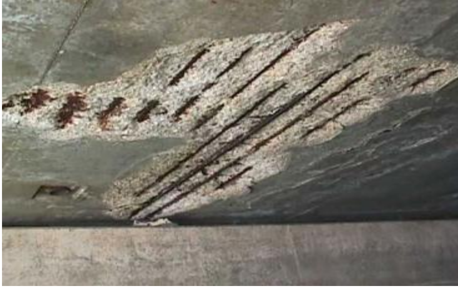
Resim 2.7. Karbonatlaşma sonucu donatı korozyonu [59]
