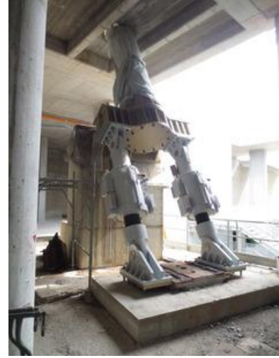
b) Yapıda kullanılan viskos damperler
