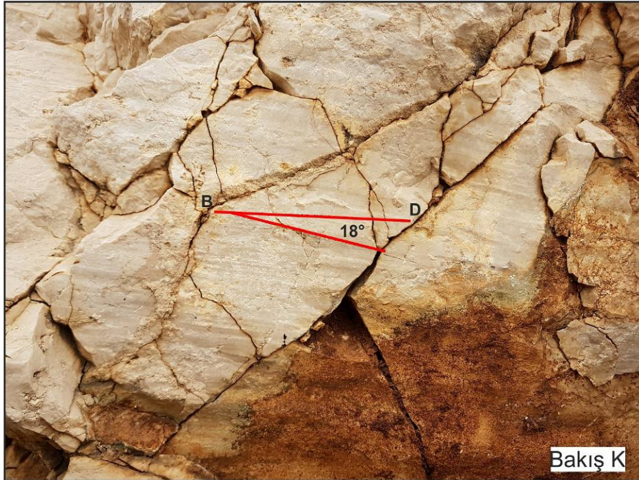
Şekil 4.4. L4 lokasyonuna ait fay düzlemi
