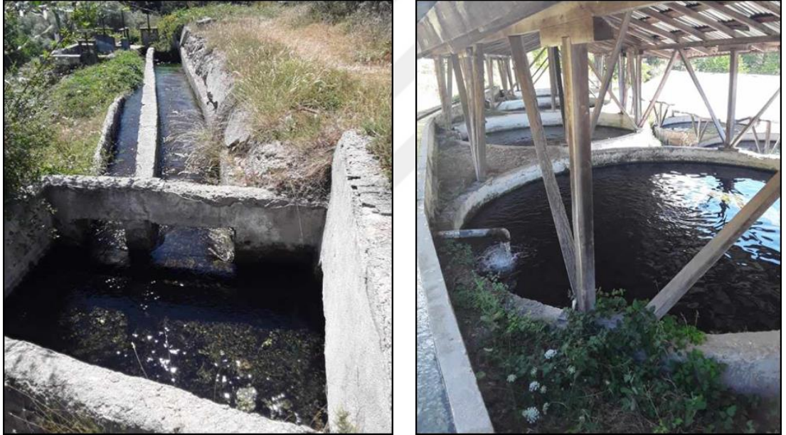
Şekil 3.4 Yürekveren Kaynağı – Kastamonu / Devrekâni
