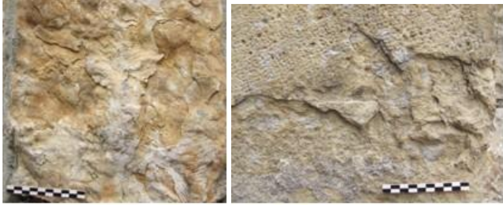
Şekil 4.20. Cephe taşlarında gözlenen kabuklanma
