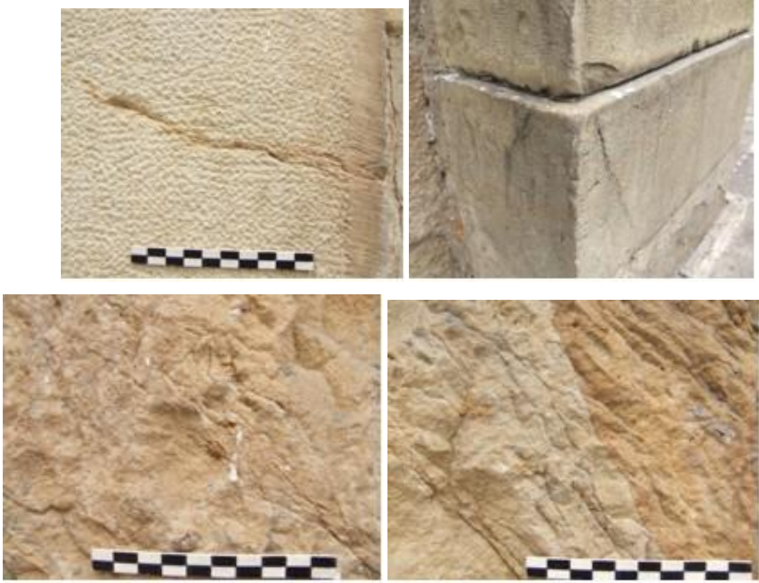
Şekil 4.27. Taşlarda görülen kendi yapısına bağlı olarak veya kayaç yapısından bağımsız olarak gelişen çatlak ve yarıklar
