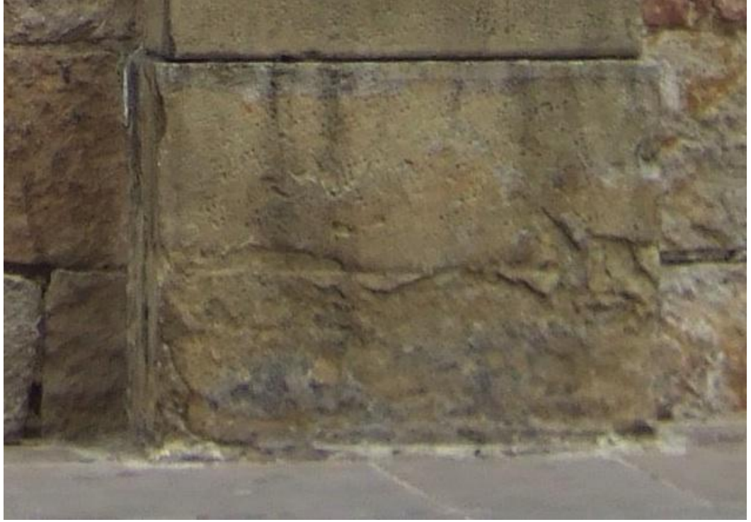
řekil 4.28. Duvarın yerle birleřtiđi blmlerde yođunlařan ařınma
