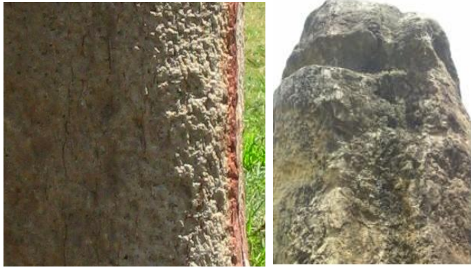
Şekil 4.18. Monolitlerde görülen kayaç yapısına bağlı çatlaklar
