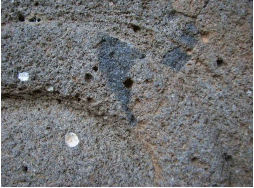
řekil 4.33. Bazı eserlerin yüzeyinde görölen küçük boyuttaki parça düşmeleri
