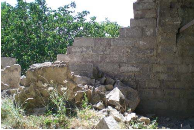
Şekil 5.126. Yıkılmış D3 duvarı
