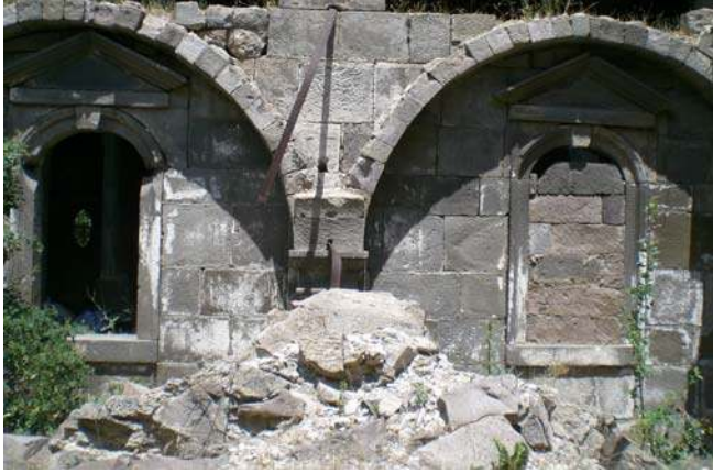
Şekil 5.58. Yıkılmış galeri altı görünüm
