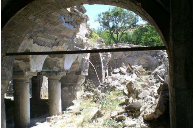
Şekil 5.125. Yıkılmış galeri katı görünümü
