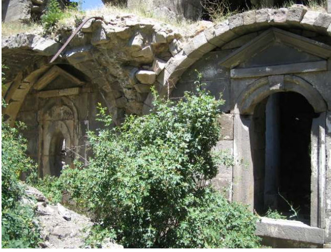
Şekil 5.57. Yıkılmış galeri altı
