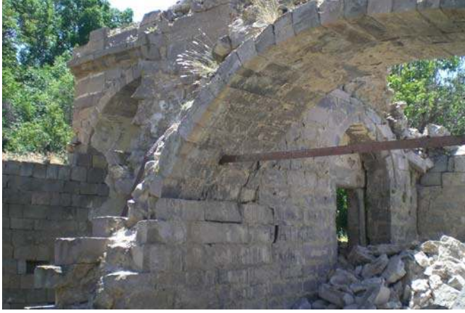
Şekil 5.128. Yıkılmış galeri katı D1 duvarı
