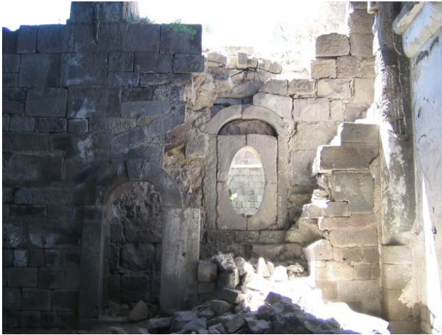
Şekil 5.96. D7 duvarı yıkılmış galeri çıkış merdiveni
