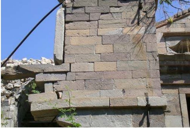
Şekil 5.52. Güney cephesi yıkılmış galeri duvarı
