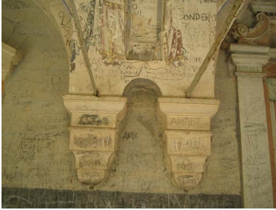
Şekil 5.43. Batı cephesi detay
