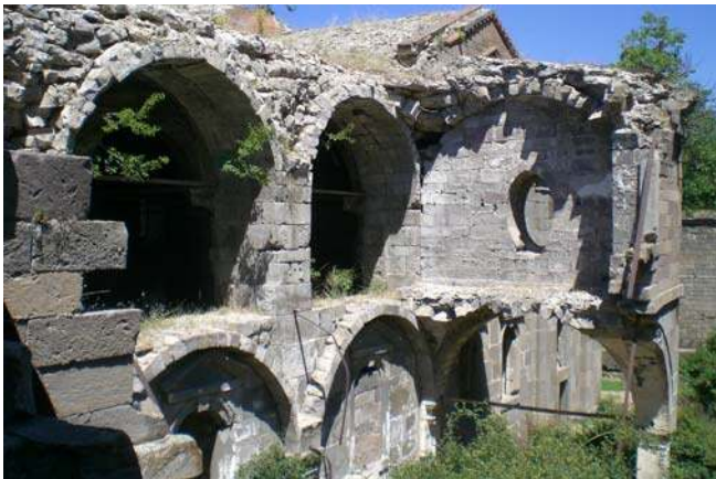
Şekil 5.50. Yıkılan güney cephesi
