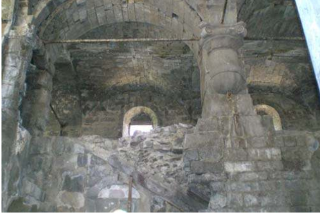
Şekil 5.98. D2 duvarı yıkılmış galeri çıkış merdiveni
