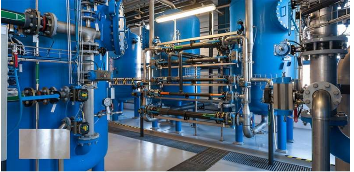
Şekil 1: HVAC sistemleri için kullanılan Vana kontrol odası (Food Sector Construction,2025)
