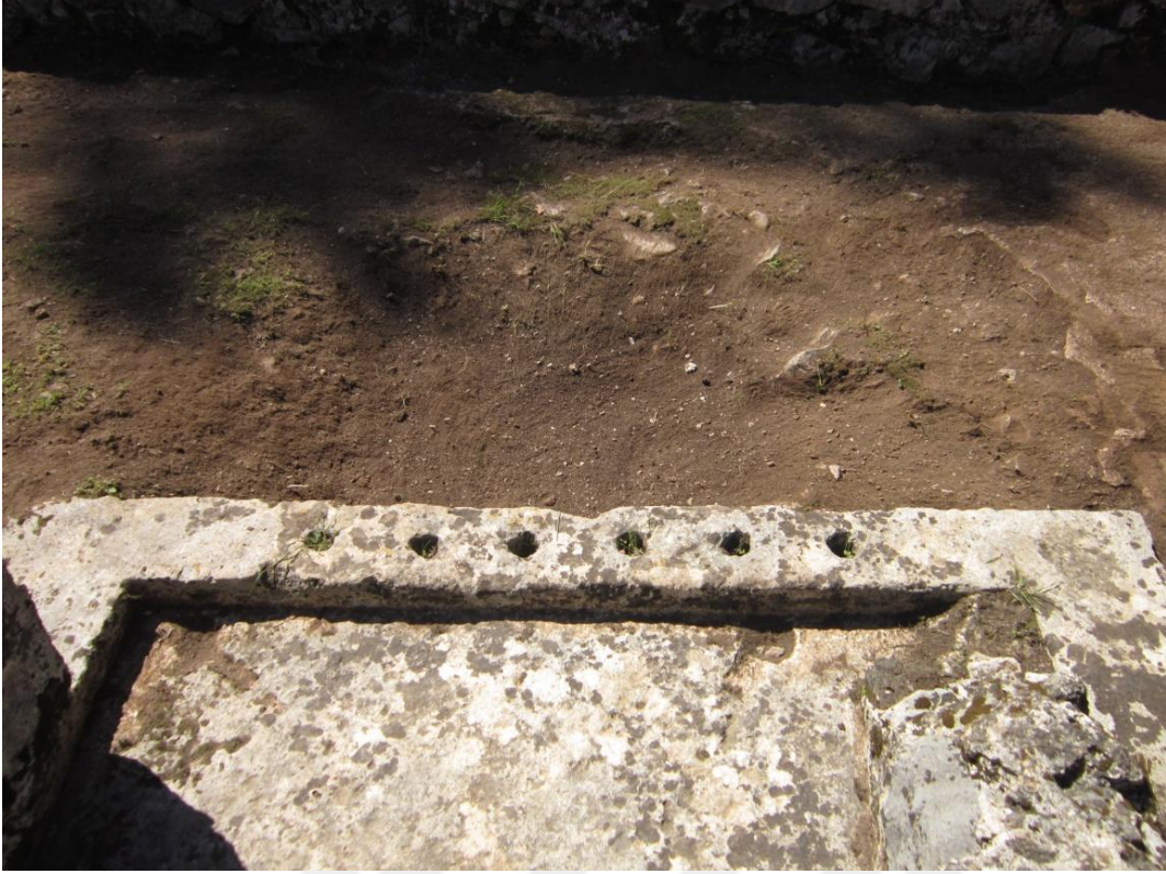
Foto 43 Çatıda Yer Alan Eşikli Sahanlığın Zemininden Detay
