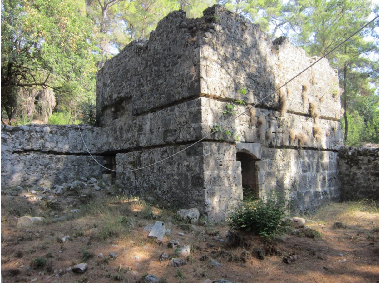
Foto 104 Köşk Cephesindeki Hatıl Boşlukları
