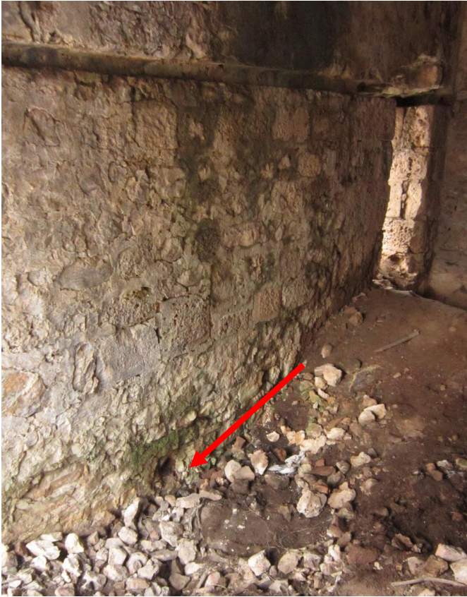
Foto 110 I. Avludan Köşke Uzanan Su Künkünün Köşk Ana Mekanındaki Tahrip Olan Bölümü
