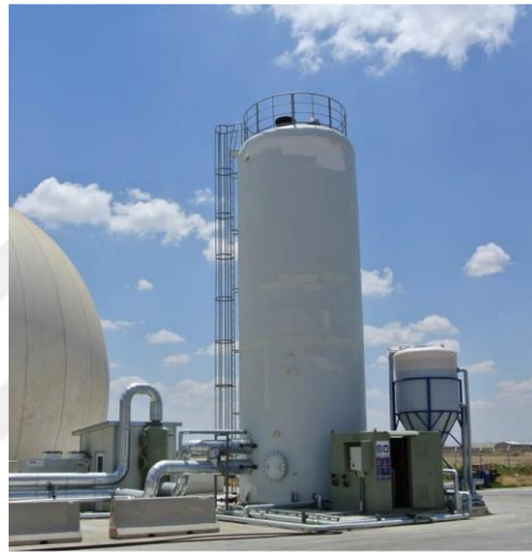
Şekil 3.17. Desülfürizasyon ve enerji geri kazanım ünitesi.
