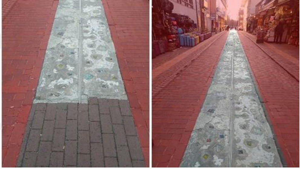
Şekil 3.44. Hamamyolu aksı Köprübaşı giriş kısmı malzeme durumu (Kişisel arşiv)
