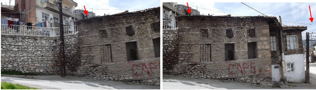
Resim 4.106. Yapıya bitişik yol üzerindeki araç yoğunluğu nedeniyle beden duvarında eğilme
