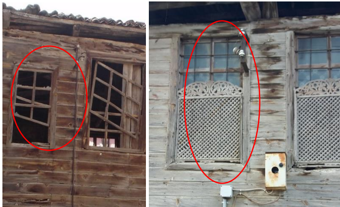
Resim 4.103. Geleneksel yapı cephesinde elektrik aksamı
