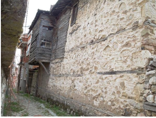
Resim 4.90. Yapıda zemin suyu ve cephe nemine örnek
