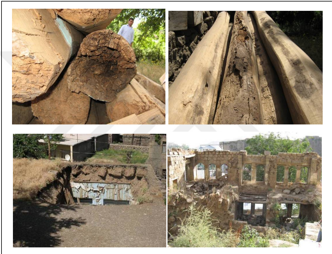
Resim 6.7. Ahşap kirişlemelerin bozulmasıyla toprak damın yıkılması
