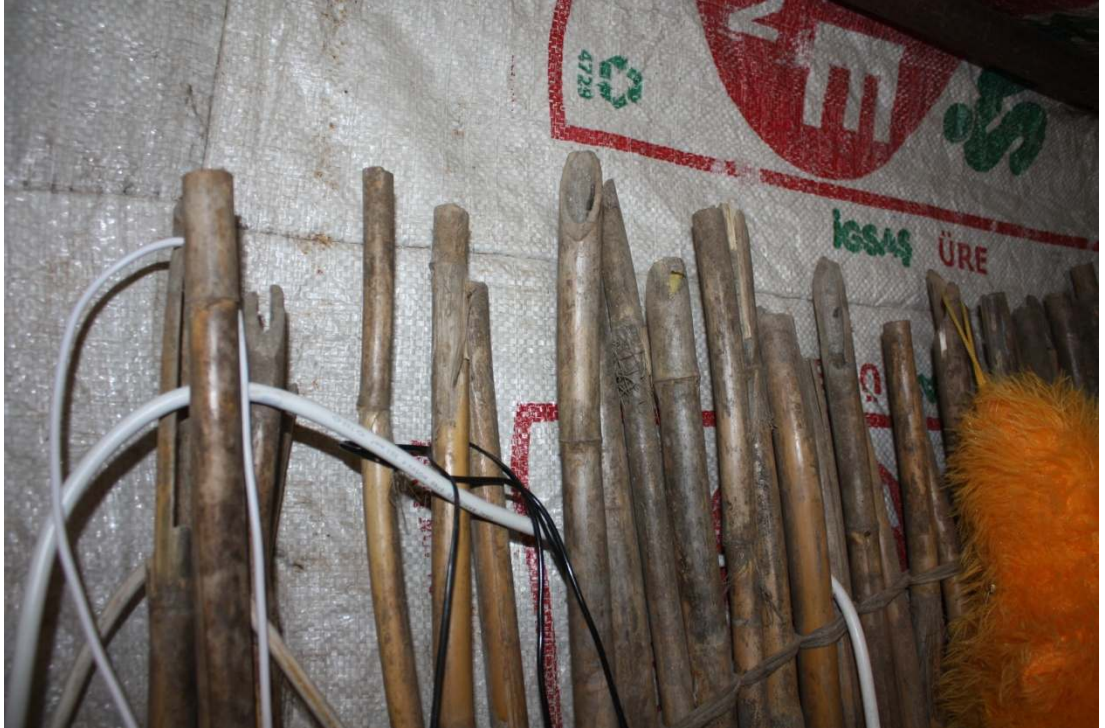
(Ek 3.3 – b): elektrik kabloları
