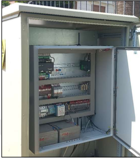
Şekil 3.8. DMA girişinde sürekli çevrimiçi izleme sistemi ve veri aktarımı için oluşturulan SCADA izleme istasyonu kabini.
