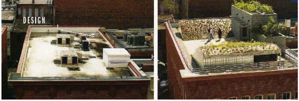
Şekil 142: ASLA Çatısının Eski ve Yeni Görünüşleri
