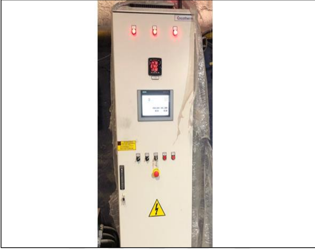
Şekil 4.33 Filtreleme havuzu elektrik ve PLC kontrol ünitesi görseli
