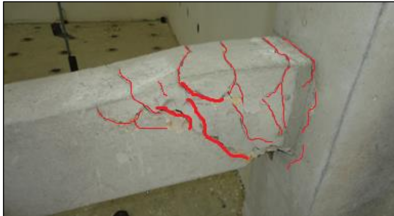
Şekil 4.90. S10 deney elemanında meydana gelen çatlak gelişimi
