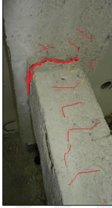
Şekil 4.63. S7 deney elemanında meydana gelen çatlak gelişimi.
