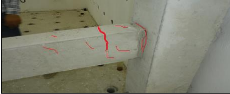
Şekil 4.117. S13 deney elemanında meydana gelen çatlak gelişimi
