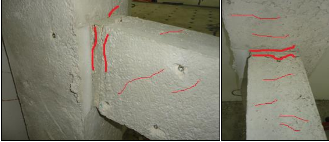
Şekil 4.27. S3 deney elemanında meydana gelen çatlak gelişimi
