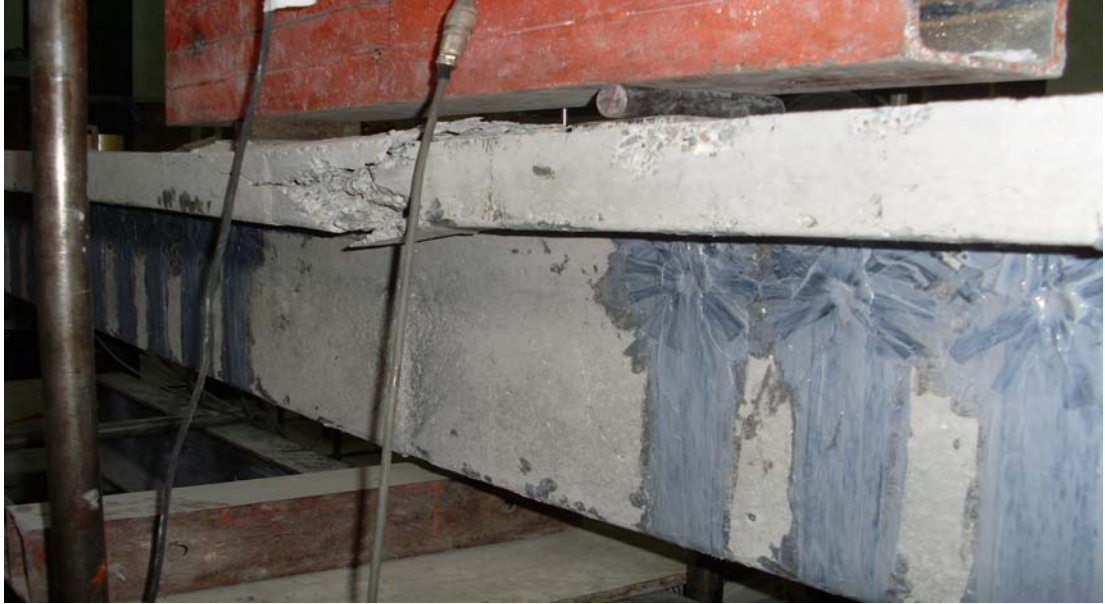
Resim 4.12. Tabla betonunda ezilme, deney elemanı 5
