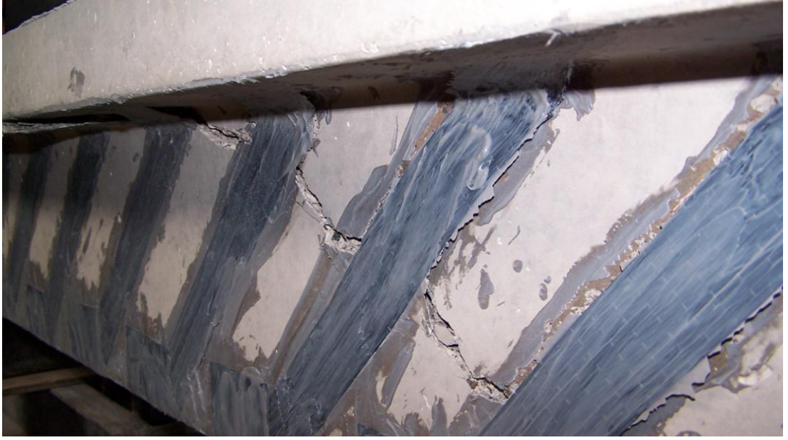
Resim 4.12. Sol kesme açıklığı ana kesme çatlağı (kiriş diğer yüzü), deney elemanı 4
