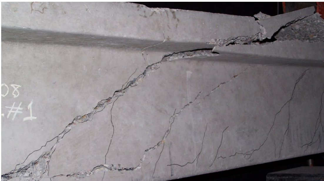
Resim 4.3. Sol kesme açıklığı ana kesme çatlağı, deney elemanı 1
