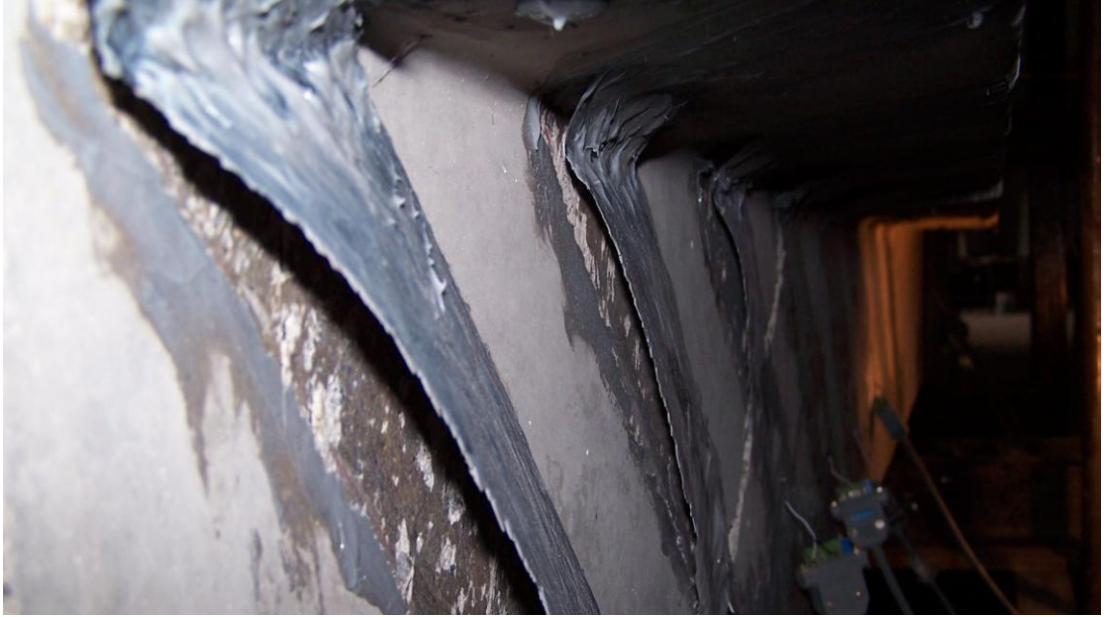
Resim 4.13. CFRP şeritlerin kiriş yüzeyinden soyulması, deney elemanı 4
