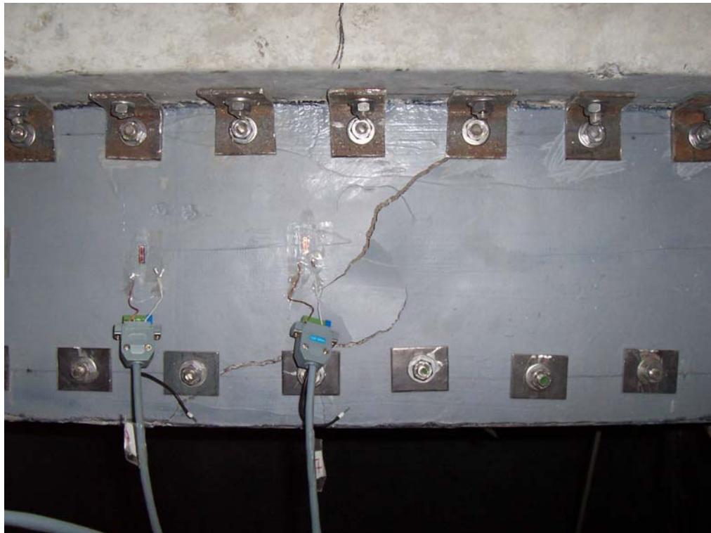
Şekil 3.21 Deney elemanı 4'de oluşan kesme çatlağı
