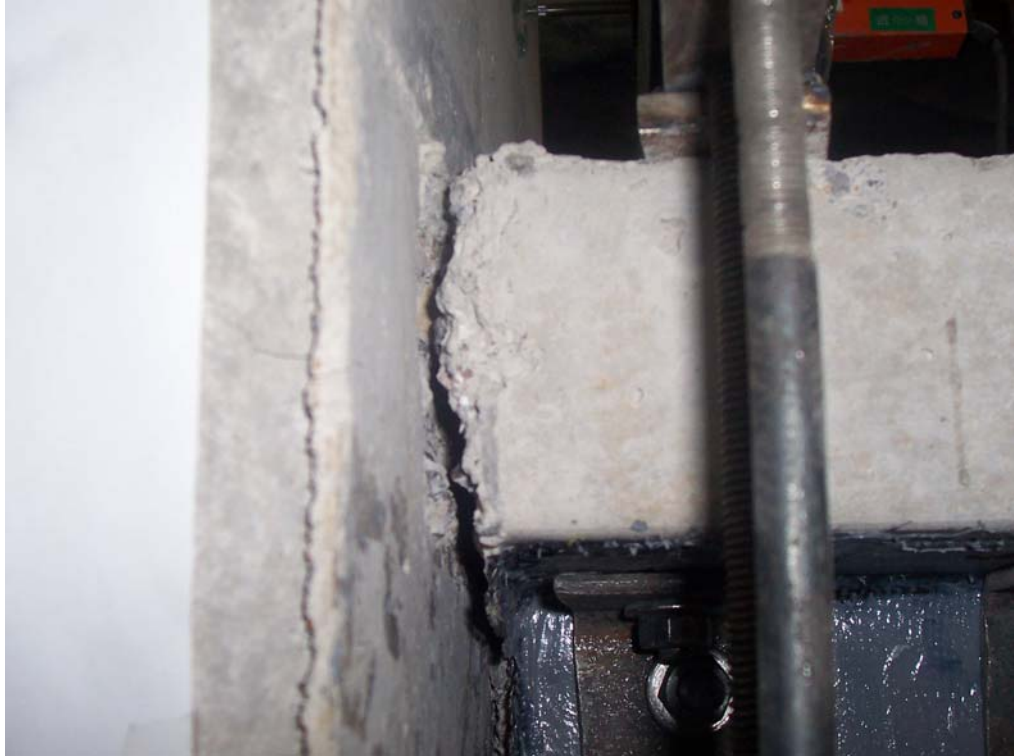
Şekil 3.45 Deney elemanı 8'in birleşim bölgesinde tabladaki ayrılma çatlağı
