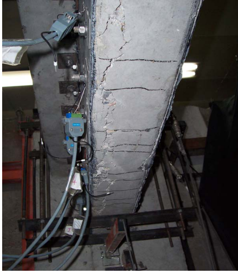
Şekil 3.32 Deney elemanı 6'nın kiriş alt yüzeyinde oluşan çatlaklar
