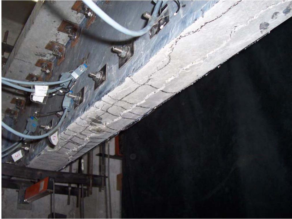
Şekil 3.9 Deney elemanı 2'nin kiriş alt yüzünde oluşan paralel ve dik çatlakların görünümü
