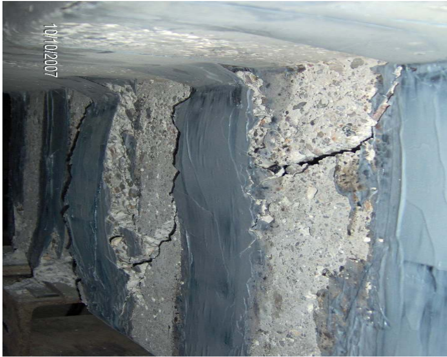
Resim 4.4. CFRP şeritlerin kiriş yüzeyinden soyulması
