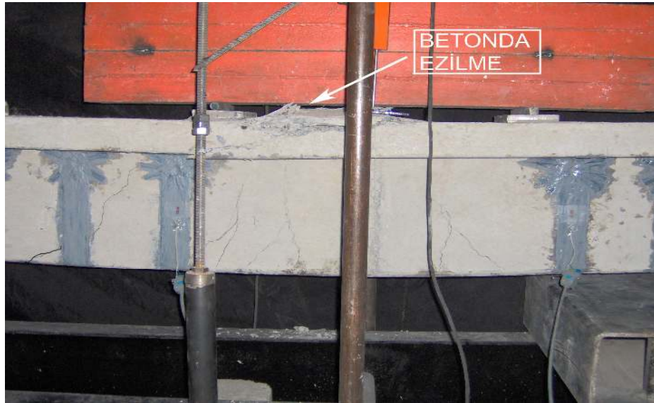
Resim 4.12. Tabla betonunda ezilme, deney elemanı 7
