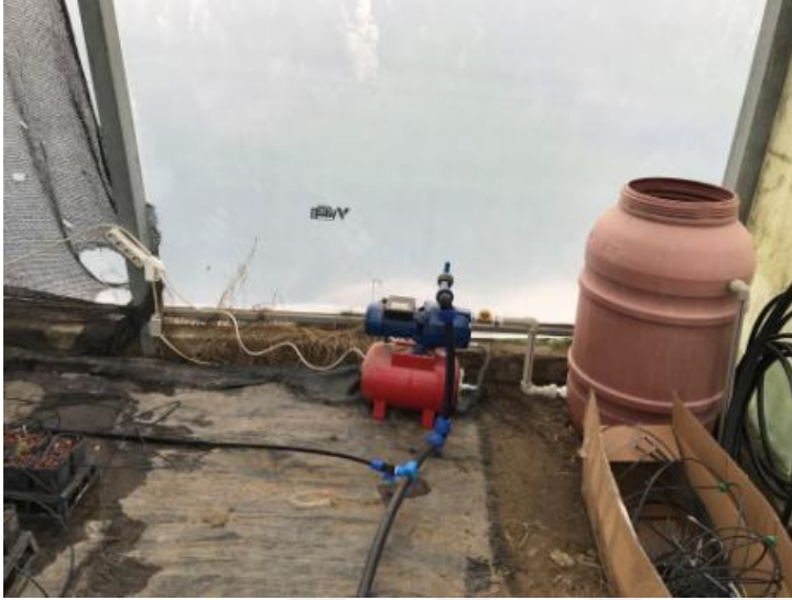
Şekil 3. 17. Elektrik motoru ve besin çözeltisi tankı
