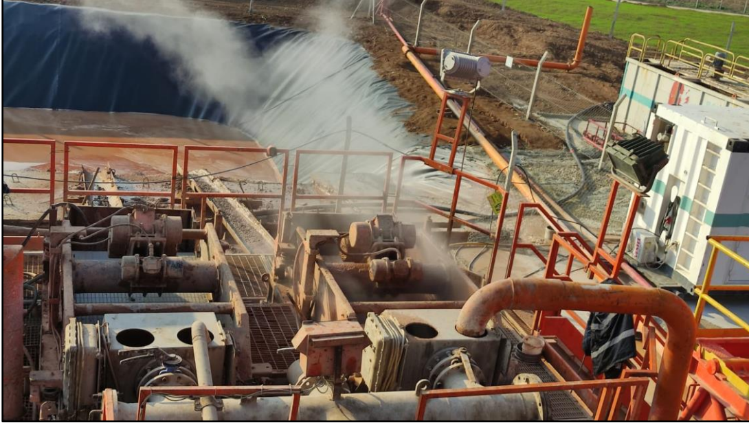
Şekil 3.2. Kuyudan dönen çamurunun ıslah edildiği katı malzeme kontrol ekipmanlarının genel görünüşü.
