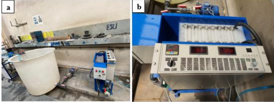
Şekil 4.1. a) Tuz tankı, EC besleme pompası ve EC reaktörü; b) yumuşatma filtresi atıksuyu için EC çalışması
