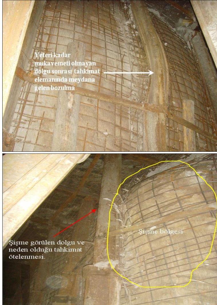
Şekil 5.2. Dolguda yetersiz dayanımın neden olduğu tahkimat elemanında bozulmalar (Çavuşoğlu, 2007).
