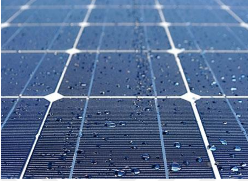
Şekil 4.8. Yağmur etkisinde kalmış güneş panelleri [71].
