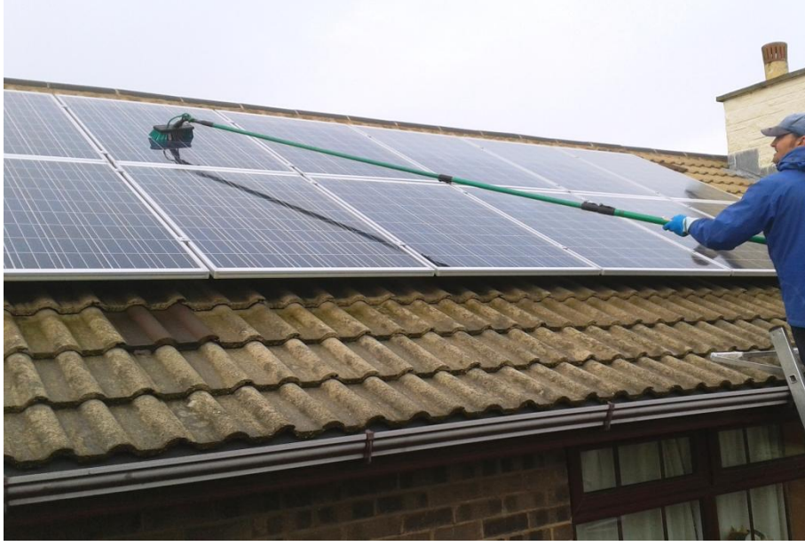
Şekil 4.2. Güneş paneli temizleme [58].
