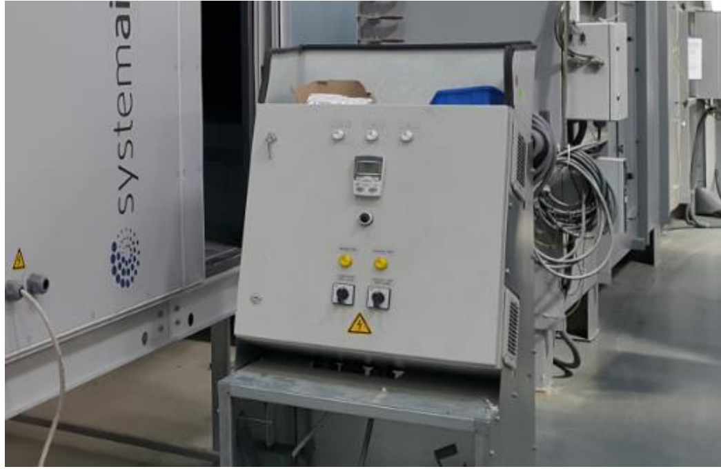
Şekil 4.5.a Fanın frekans kontrol paneli
