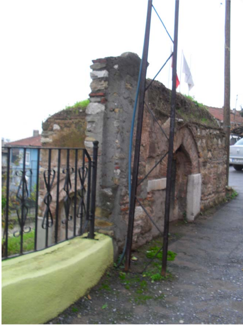
Fotoğraf 29. Kuzey ve batı cepheleri arasındaki kot farkı
