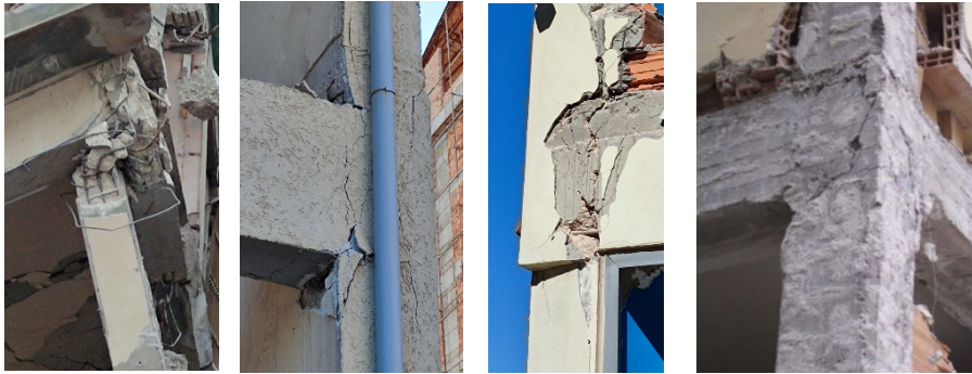
Şekil 1.1. Deprem sonrası kenar (dış) aks kolon-kiriş birleşim bölgelerinde meydana gelen hasarlar (Arslan ve Korkmaz (2007); Metelli ve diğ. (2015); Doğan TP (6-20 Şubat Depremleri))
