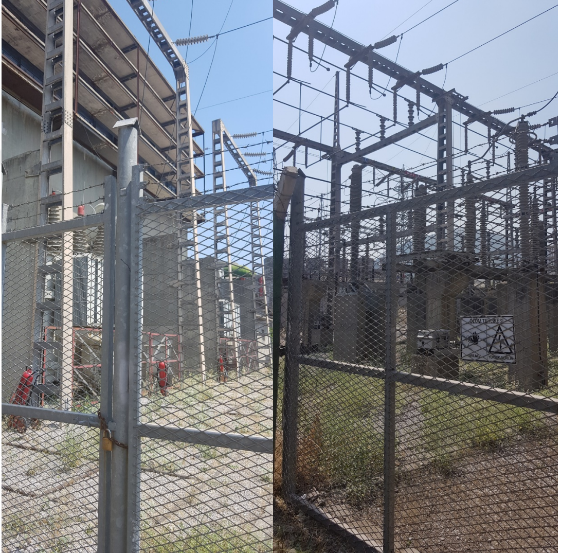
Şekil 5.31 Şalt sahası (Kişisel arşiv, 2019)
