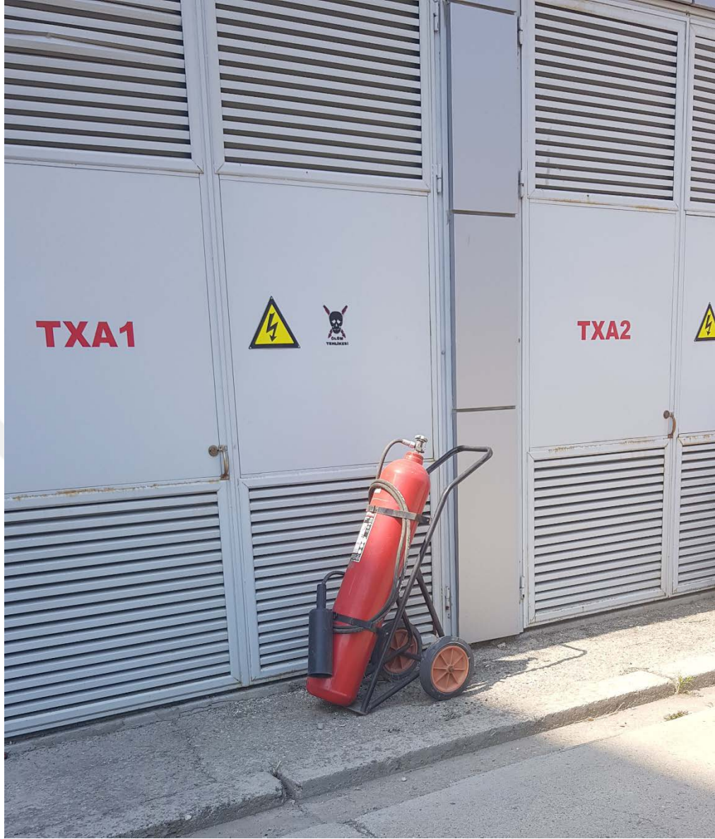
Şekil 5.7 Elektrik panosu ve karbon monoksit tipi söndürücü (Kişisel arşiv, 2019)
