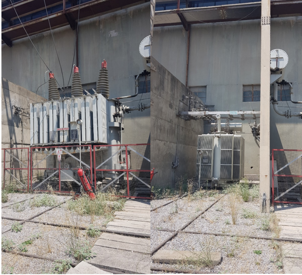
Şekil 5.33 Trafo ve transformatör (Kişisel arşiv, 2019)
