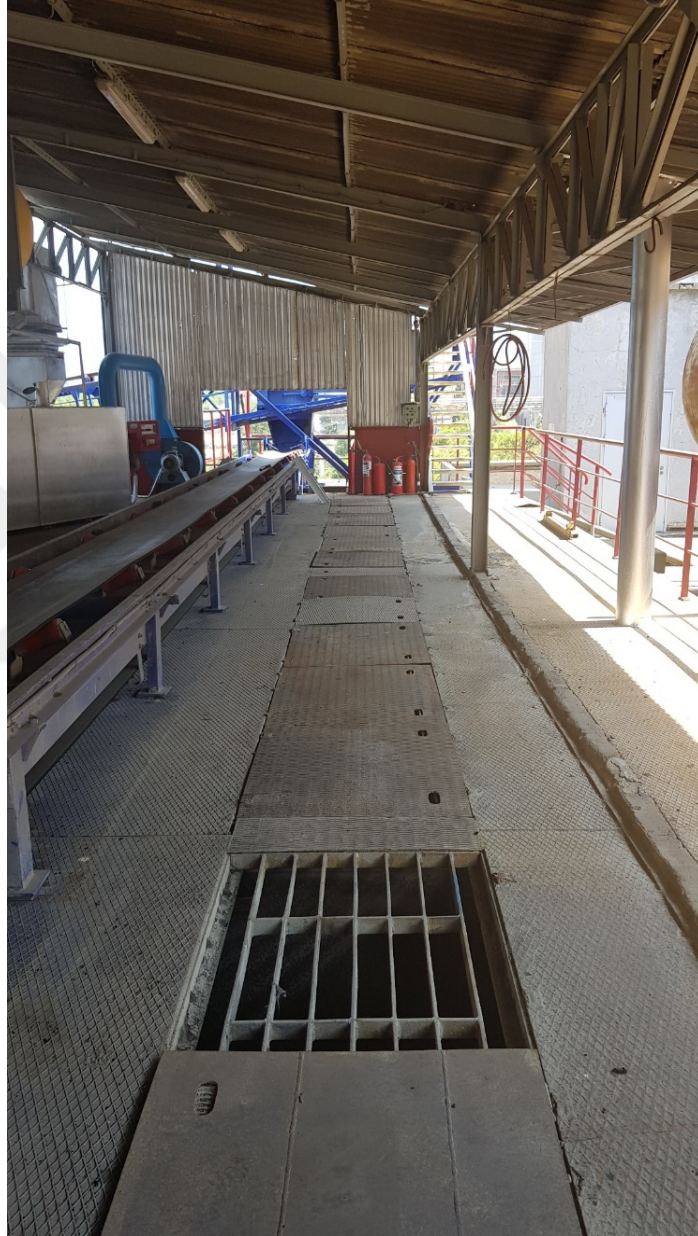
Şekil 5.9 Kömürün stoklandığı bunkerlere aktarım yapılan hat ve kapaklar (Kişisel arşiv, 2019)
