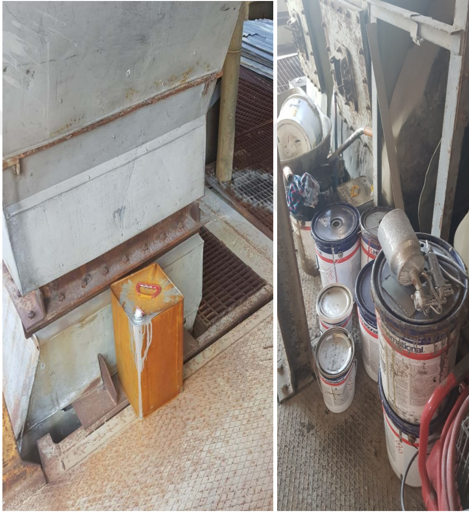
Şekil 5.12 Konveyör bant etrafında depolanan yanıcı kimyasallar (Kişisel arşiv, 2019)
