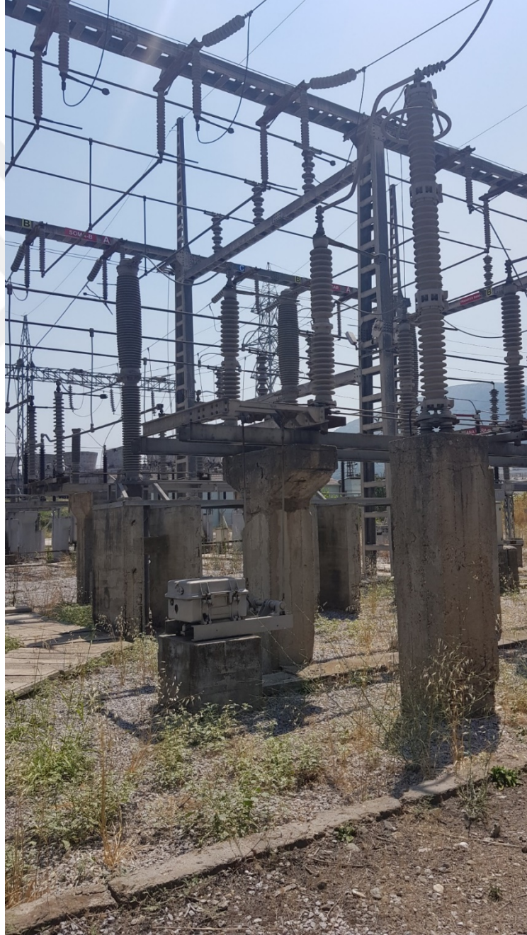
Şekil 5.30 Şalt sahası (Kişisel arşiv, 2019)
