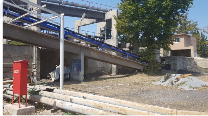
Şekil 5.2 Konveyör bant ve aydınlatma ekipmanları (Kişisel arşiv, 2019)
