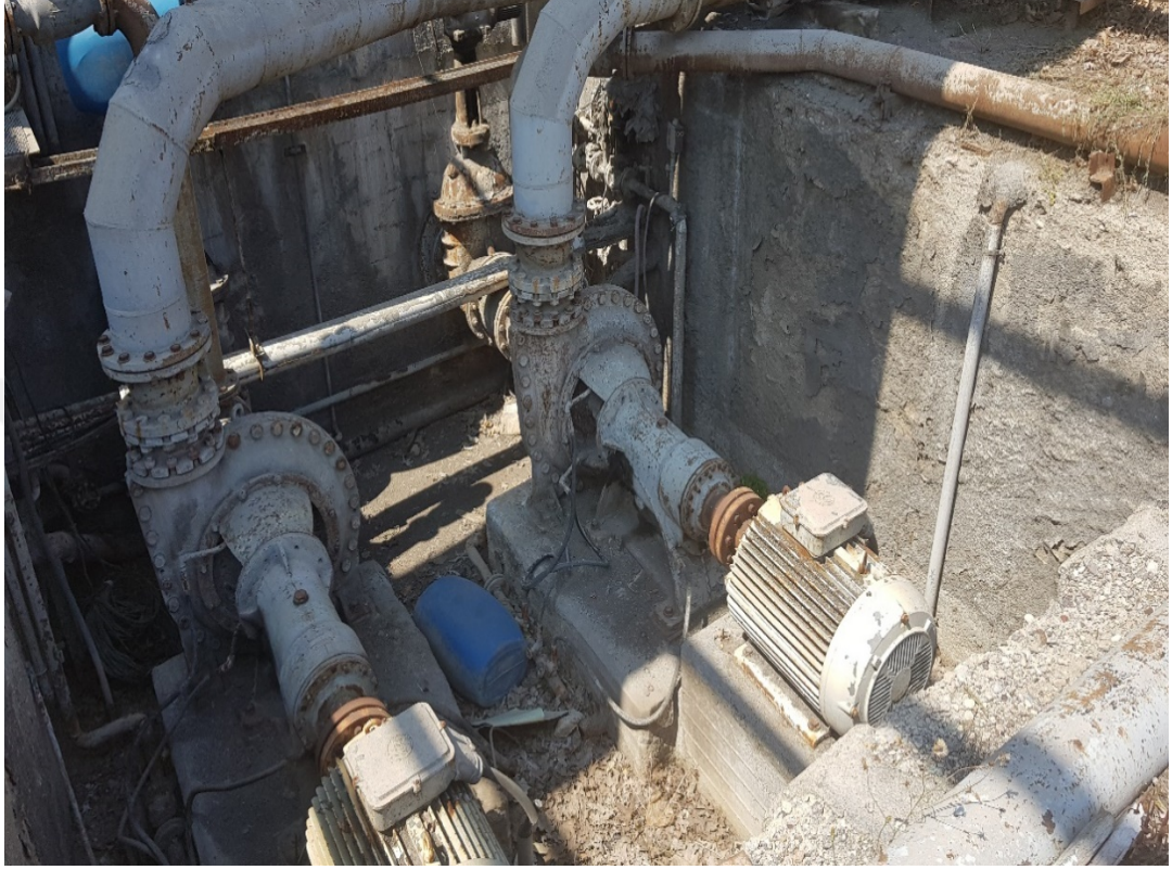
Şekil 5.4 Giriş hattında bulunan pompalar (Kişisel arşiv, 2019)
