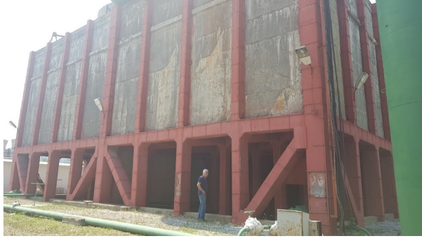
Şekil 5.28 Soğutma kulesi su havuzu (Kişisel arşiv, 2019)
