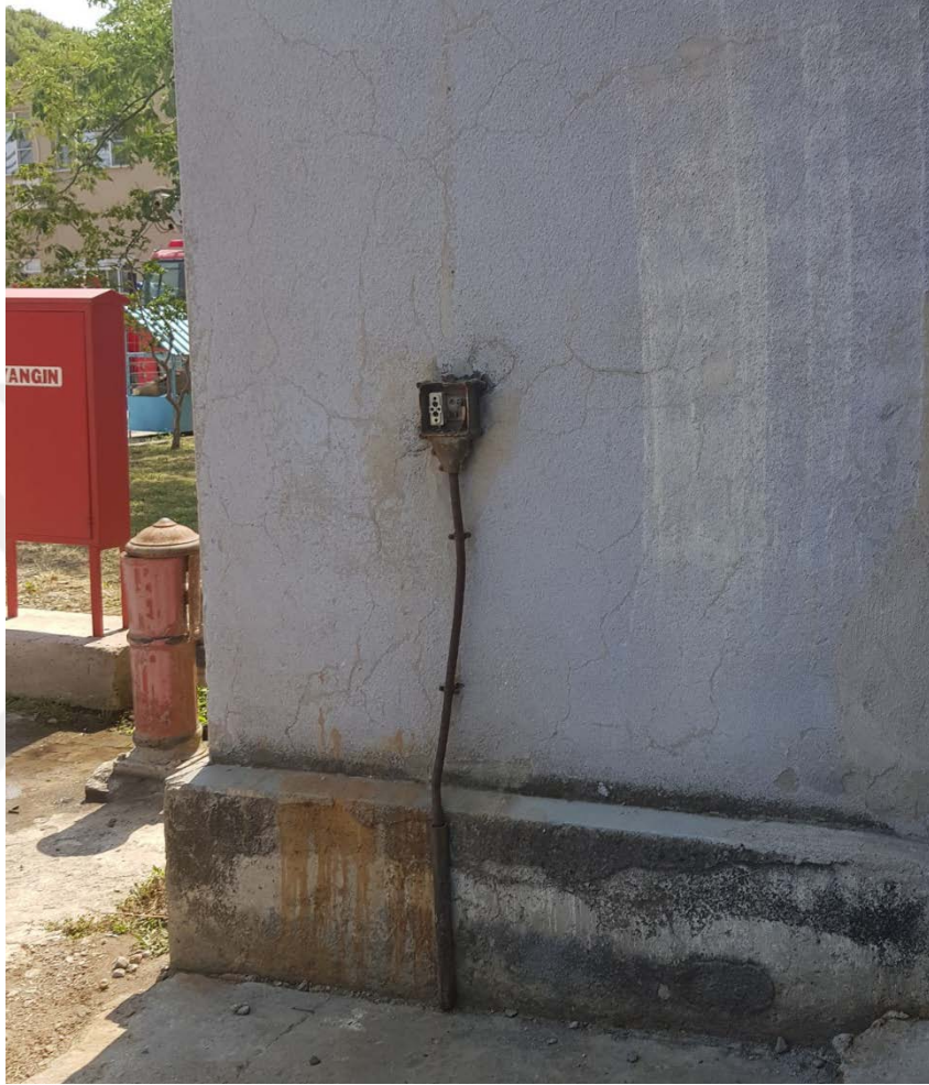
Şekil 5.8 Hasarlı durumda bir kablo ve açma kapama tuşu (Kişisel arşiv, 2019)
