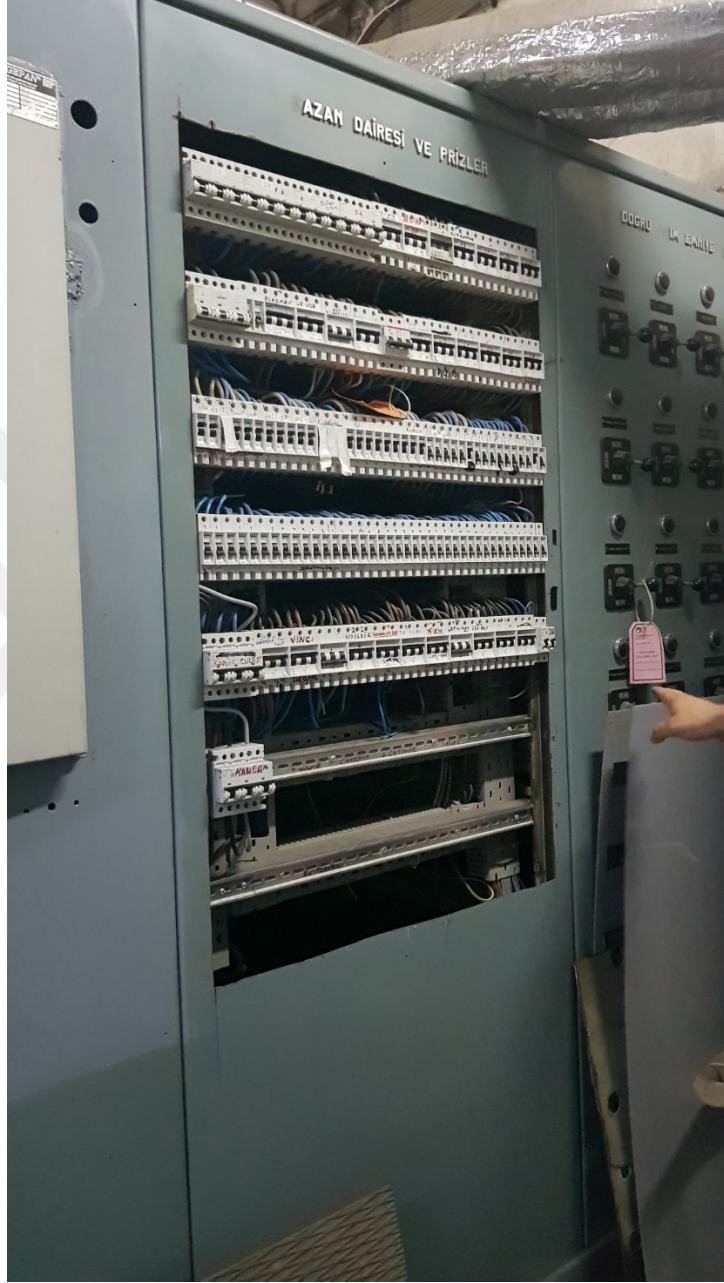
Şekil 5.35 Elektrik panosu (Kişisel arşiv, 2019)
