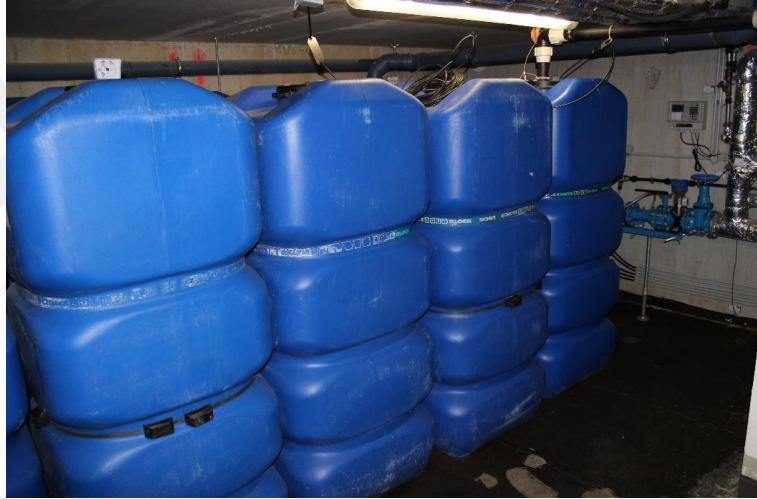
Şekil 51: Yağmur Suyu Depolama ve Pompalama Alanı
