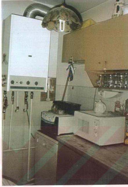
Şekil 6.21. Ü-27 nolu konutun mutfağında bulunan elektrikli cihazlar
