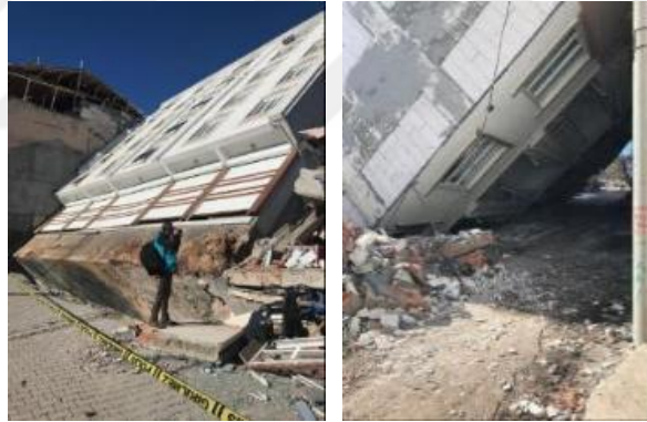
Şekil 14. Zemin sıvılaşması sonucunda ortaya çıkan hasar durumu (BTÜ, 2023)
